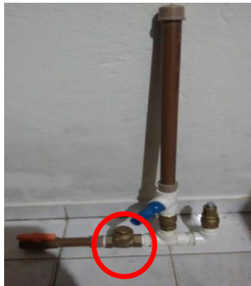
Figura 6: Carneiro hidráulico de PVC Protótipo (Fonte: Autoria própria)
