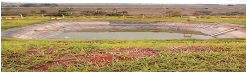
Figura 5: Lagoa de tratamento facultativo do chorume do aterro sanitário.
