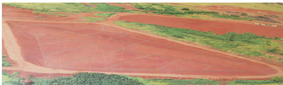
Figura 3: Canalizações internas de drenagem do chorume do aterro sanitário.
