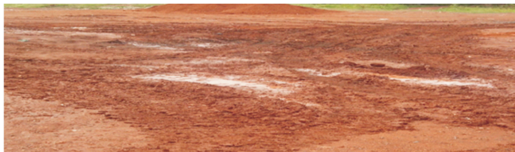
Figura 2: Sistema viário sob más condições em épocas de chuvas.
