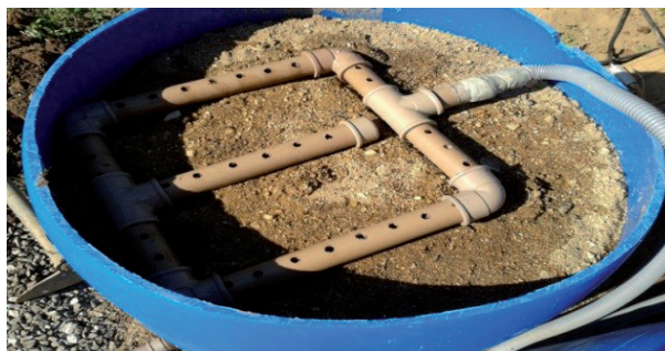
Figura 3b. Pré-filtro instalado. Tubulação de alimentação do pré-filtro. Fonte: Elaboração própria.
