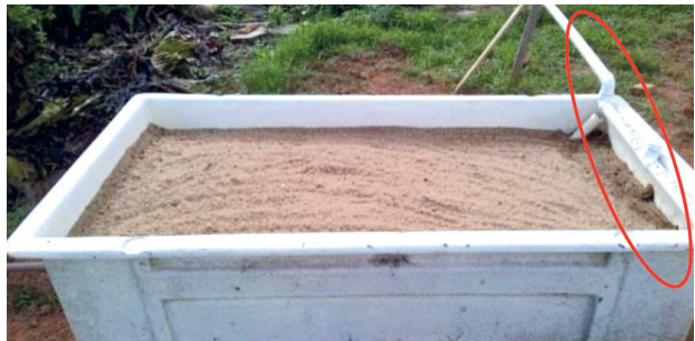
Figura 3b. Pré-filtro instalado. Tubulação de alimentação do pré-filtro. Fonte: Elaboração própria.
