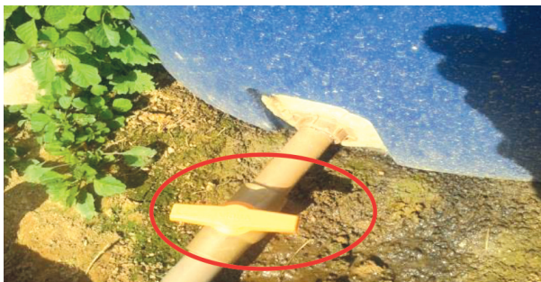
Figura 4a. Tubulação de saída, caixa de armazenamento. Fonte: Elaboração dos autores
